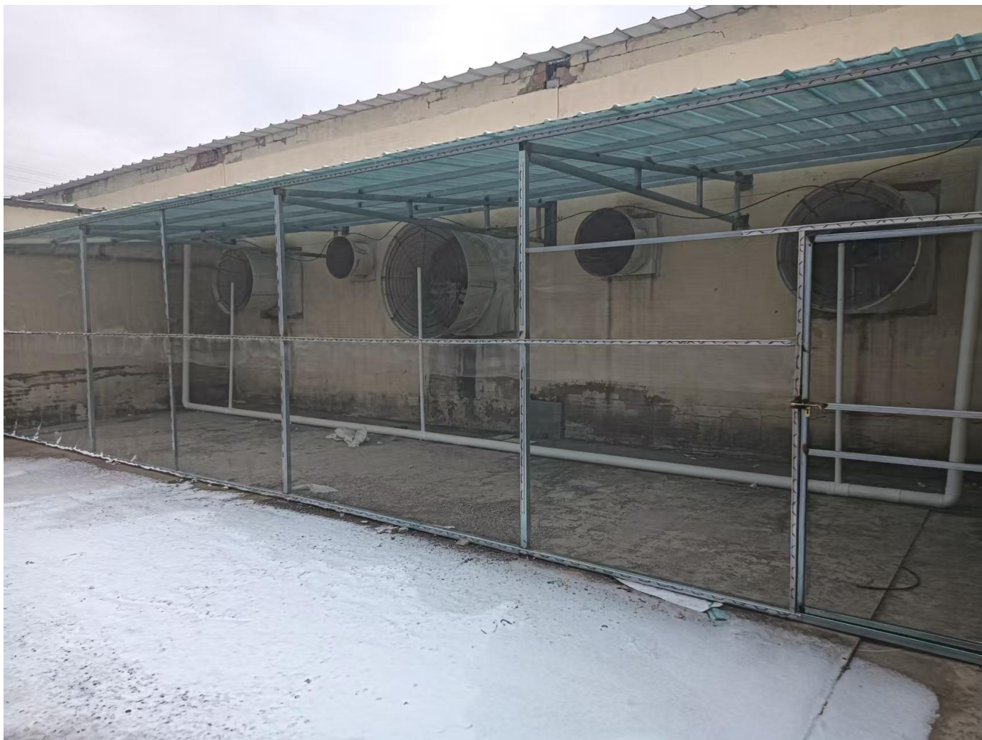
图 2 微纳米除臭间图片
