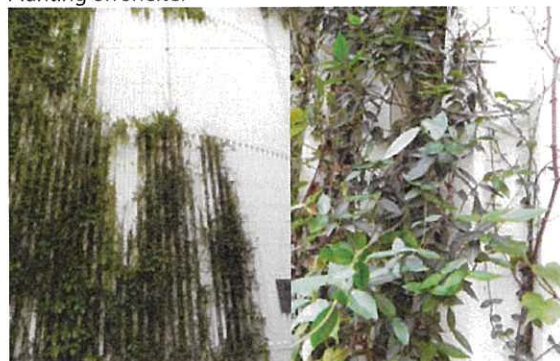
位於沙田污水處理廠的垂直綠化
